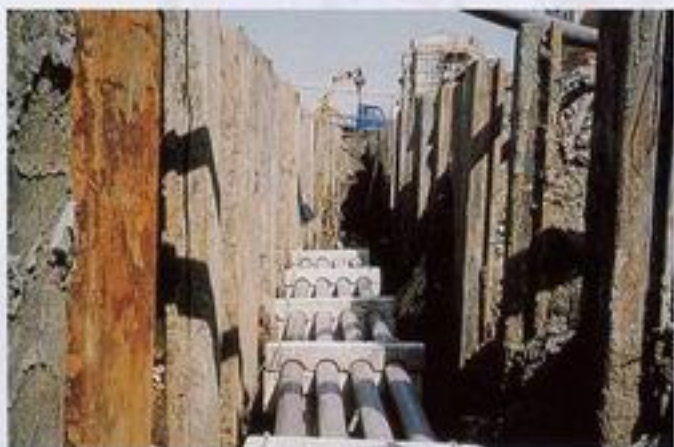
▲ 電氣工程 Electrical engineering
